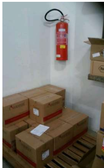
Difícil acesso do extintor
