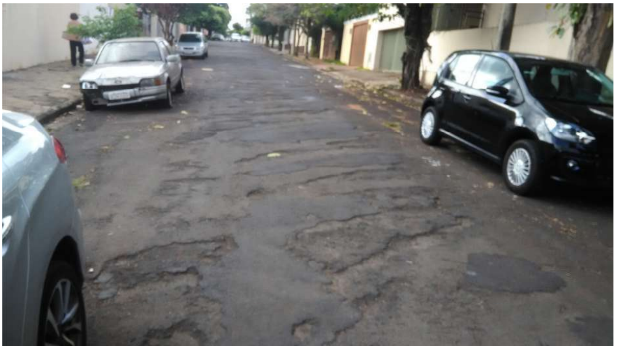
Trecho da Rua Antonio Vieira Dias necessitando de manutenção no pavimento asfáltico.
