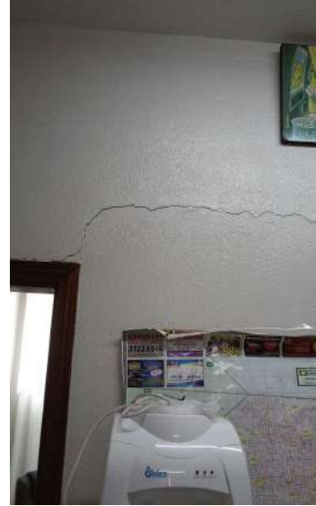
Rachaduras na secretaria
