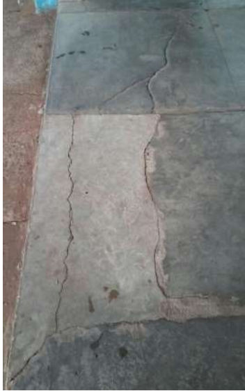
Rachaduras no pátio
