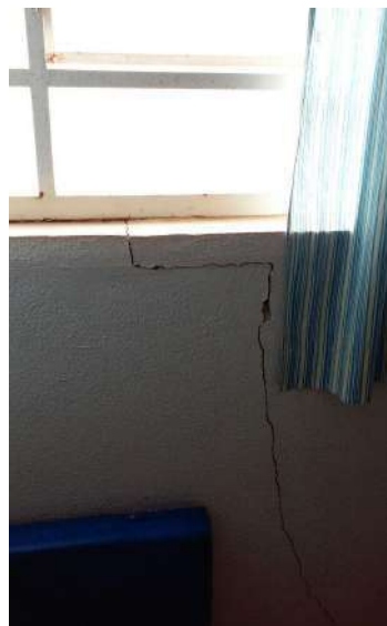
Rachaduras na sala de aula
