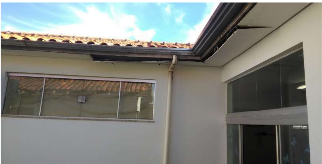
U.S.F. Jardim Eldorado: Telhado e beiral do prédio necessitando de reparos. (constatação em visita realizada em 14/05/19)
