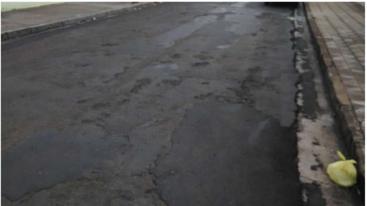
Trecho da Rua Benedito Spinardi necessitando de manutenção no pavimento asfáltico.
