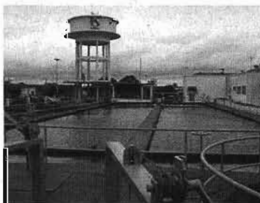
Figura 3 - Estação de Tratamento de Água (ETA).
